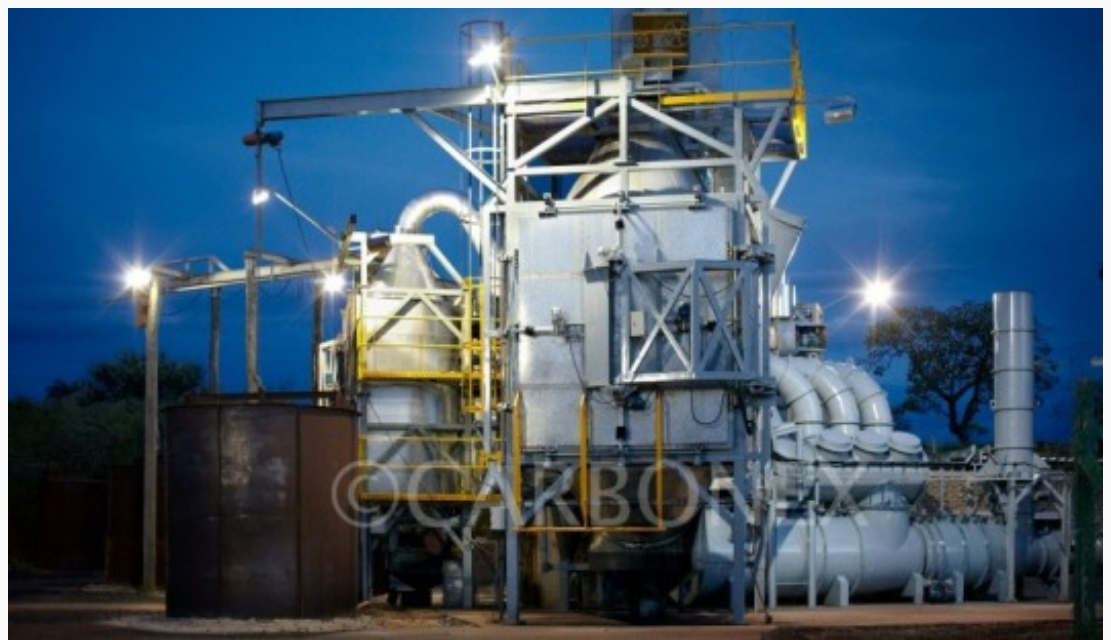
La nouvelle installation de carbonisation Carbonex à Gyé-sur-Seine
